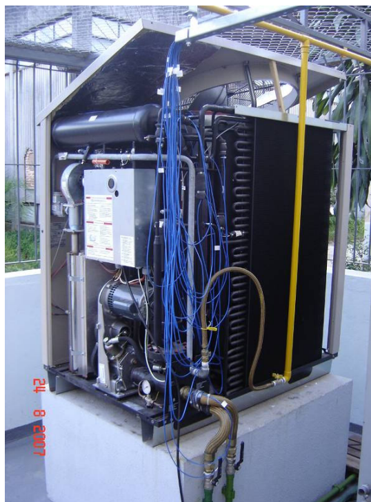
Fig. 3.3 Equipamento instrumentado para a realização dos testes
